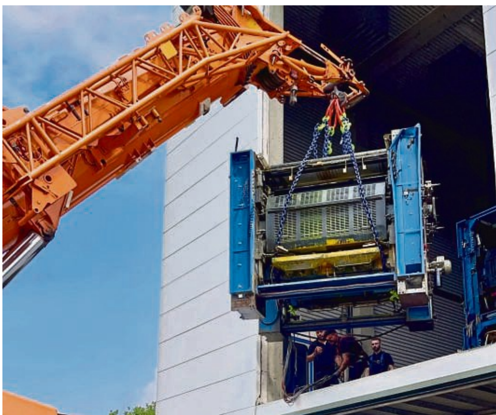
Ein Schwerlastkran hebt ein Druckwerk aus der Halle.
